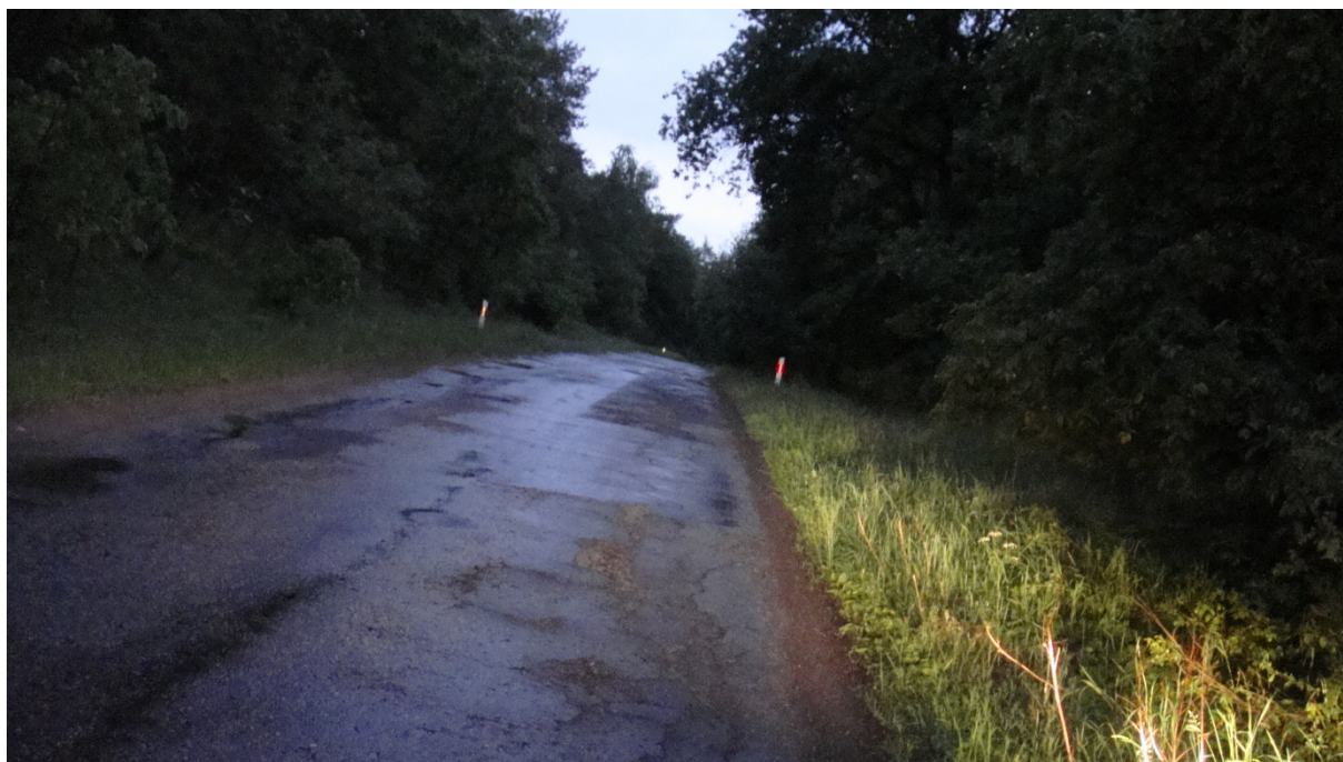
Stan nawierzchni DW 501 przed przebudową
