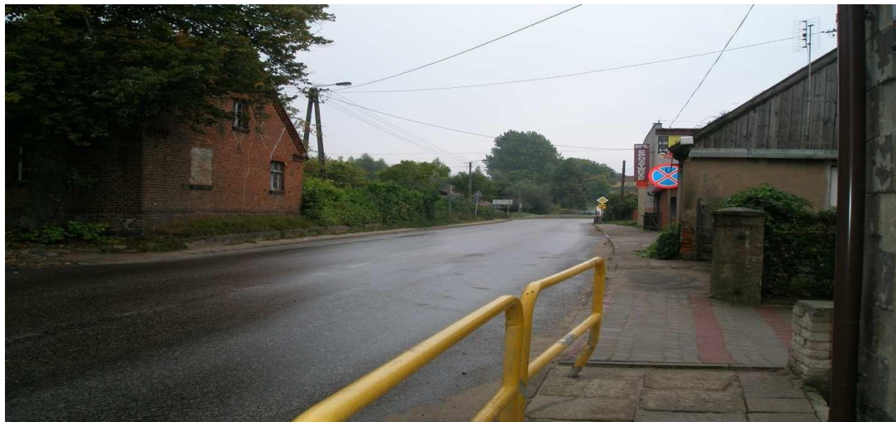
Fotografia 3 Uszkodzenia nawierzchni DW 222, nieprawidłowe parametry chodnika, brak odwodnienia drogi
