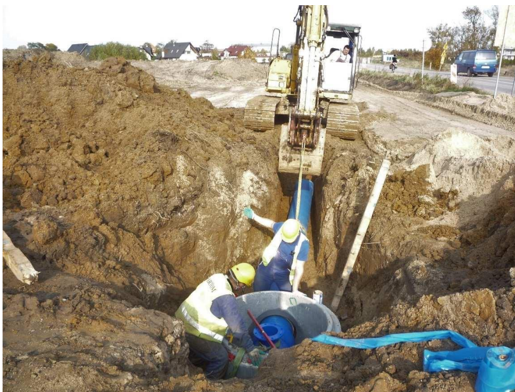
17.10.2017r. Odc. A. 0+400. Studnia rewizyjna wodociągowa dla wodociągu fi 450mm.
