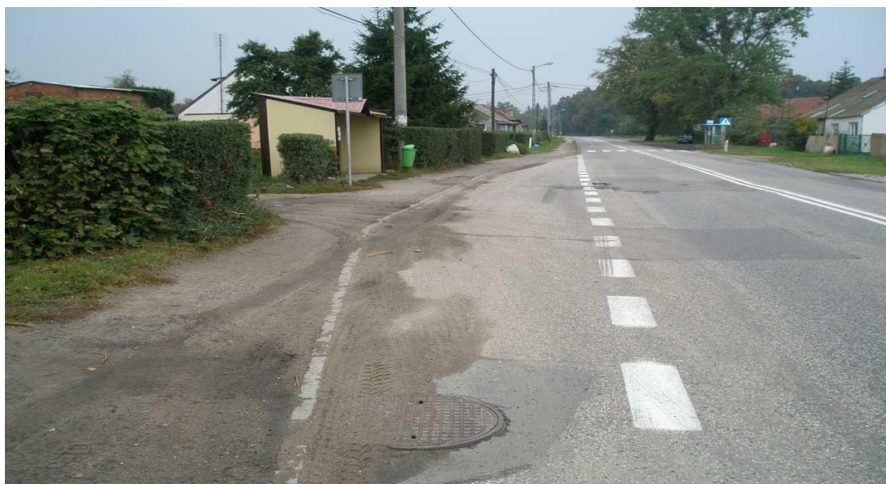
Fotografia 4 Uszkodzenia nawierzchni DW 222
